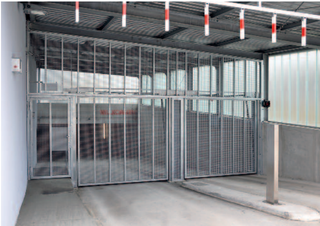
Feuerverzinkte Toranlage mit Nebentüre und Sturzverkleidung
