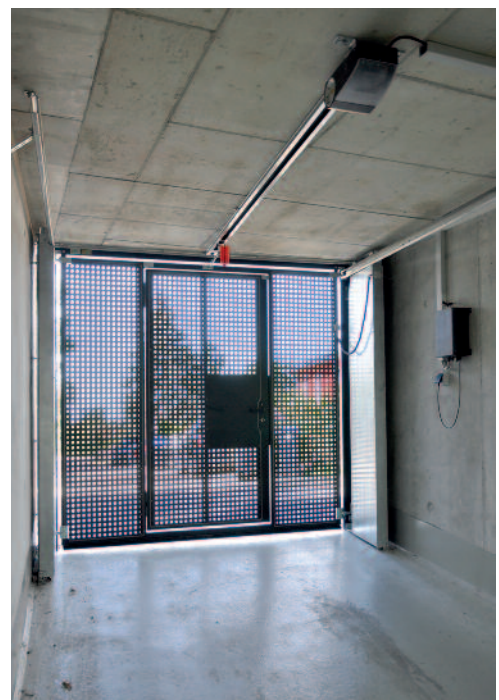
Innenansicht einer nicht-ausschwenkenden Sammelgaragentoranlage
